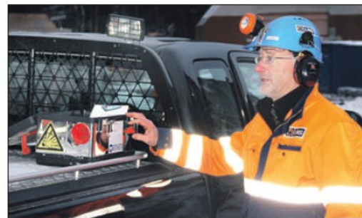
ALARMEN GÅR: Anleggsleder Arne Rasdal fra entreprenøren LNS setter i gang varslng for smellet i fjellveggen.
